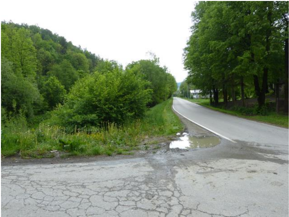
Fot. 6 Droga w kierunku Olszówki. Widoczne łęgi wzdłuż potoku Olszówka
