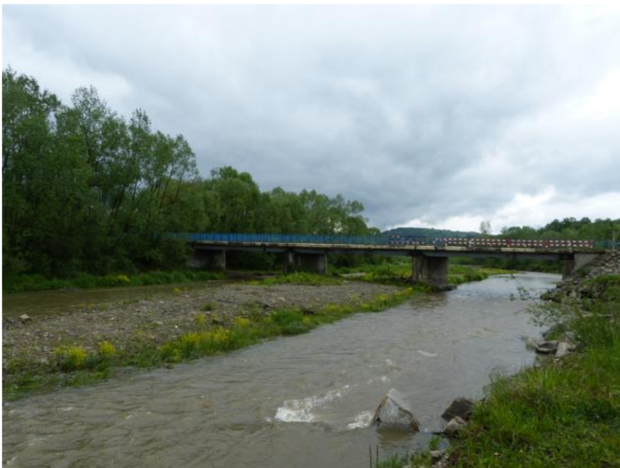
Fot 3 Most na Rabie – widoczne kamieńce i usypiska - uwaga: w chwili obecnej konstrukcja mostu rozebrana, trwa remont.
